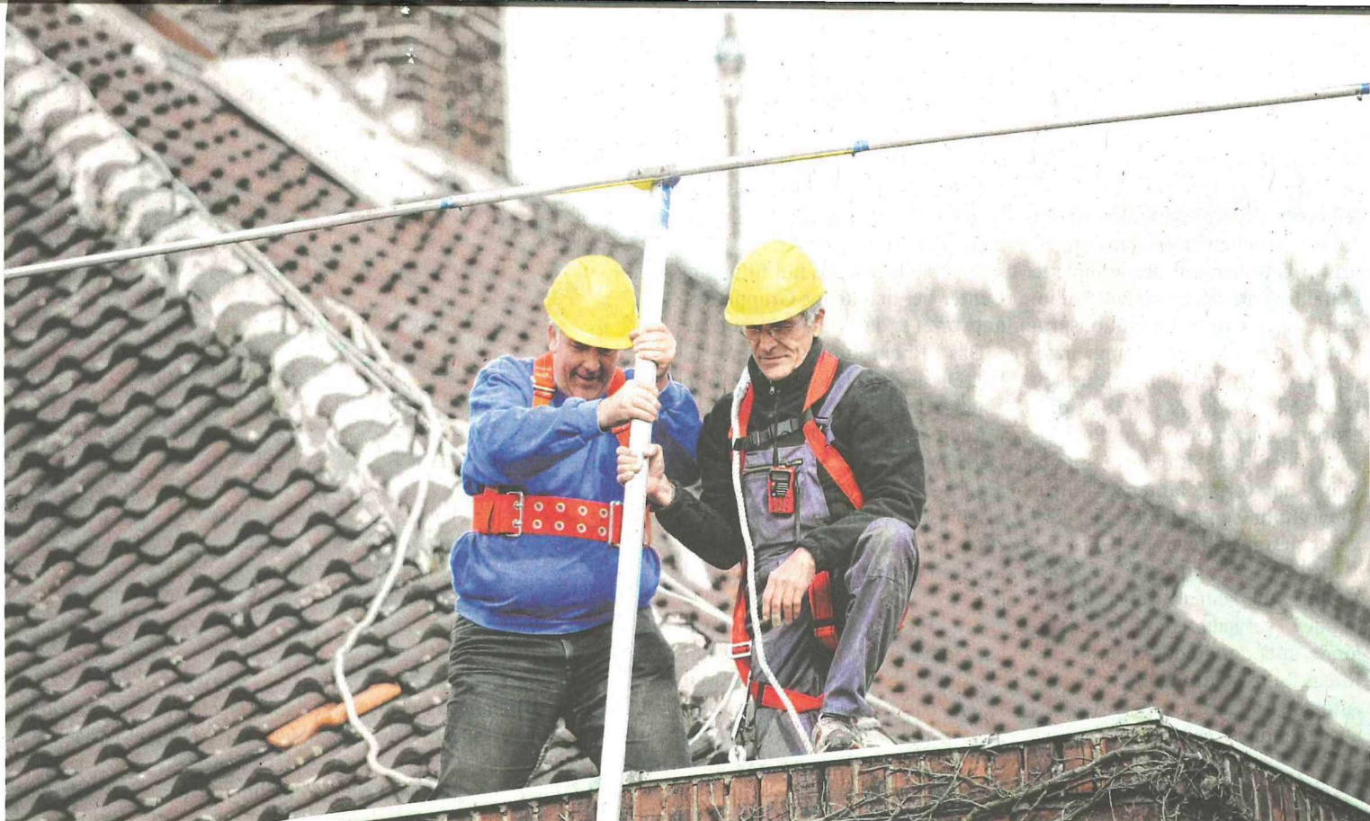
Benno Jacobs und Horst Indek (von links) montieren die brandneue Antenne auf dem Dach.
